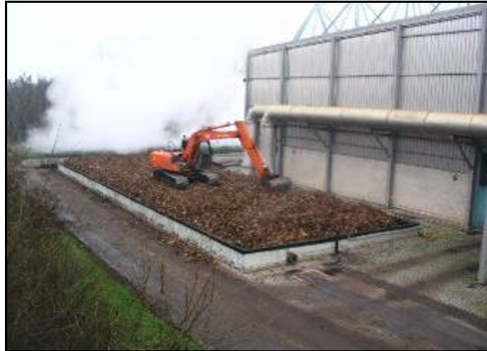
Onderhoud van een biofilter aan de composteerhal
