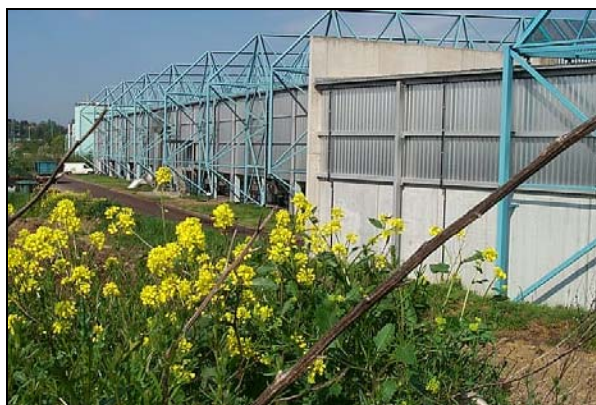
Foto 7: een zicht op de composteerhal
